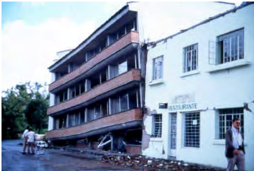
Foto 6.1: A la izquierda se aprecia un edificio nuevo en Colombia, construido por profesionales, que ha colapsado y a la derecha una casa informal sin mayores daños. En este caso, el edificio nuevo demostró ser más vulnerable que el informal.
