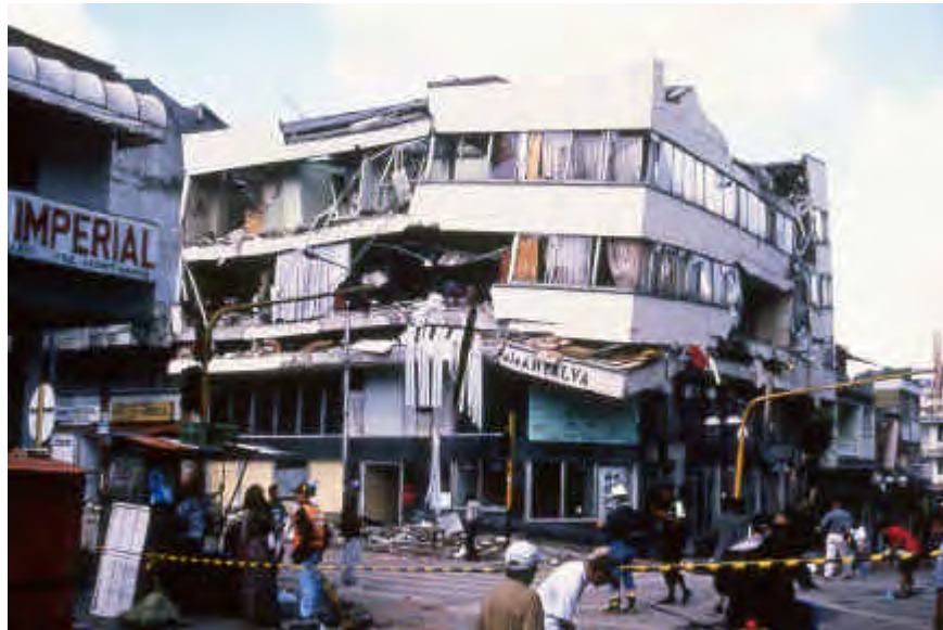
Foto 5.3: Edificio de hormigón armado construido sin normas sismorresistentes.
