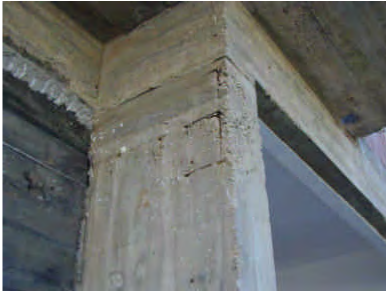
Foto 5.8: Estructura en construcción donde se detecta la falta de recubrimiento.
