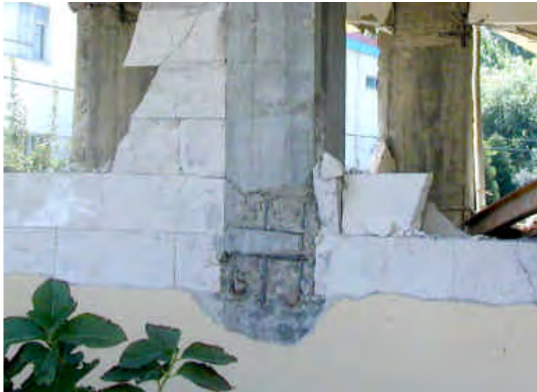
Foto 5.12: Redondos de solape en pilar con ganchos y a tope al inicio del entrepiso.
