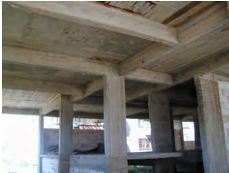
Foto 5.10: Mala configuración estructural de entramados que forman pórticos.
