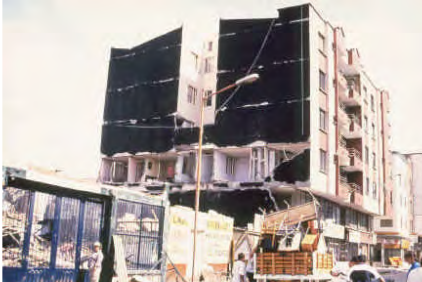
Foto 5.5: Caida de muros de tabiquería de fachada por flexibilidad de la estructura.
