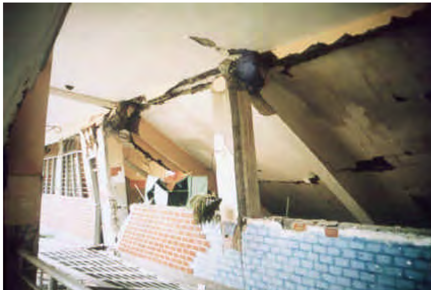
Foto 5.6: Fallo de nudos de unión vigapilar por falta de refuerzo transversal.
