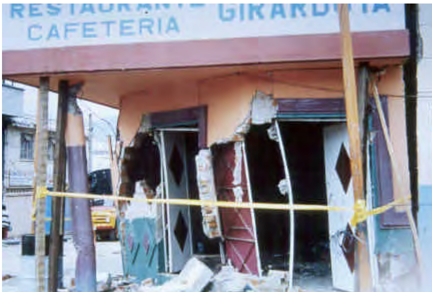
Foto 5.2: Edificio de mampostería no reforzada gravemente afectada.
