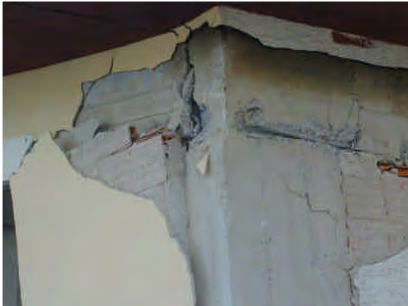
Foto 5.11: Deficiente detallado del refuerzo, falta de anclaje y de adherencia.
