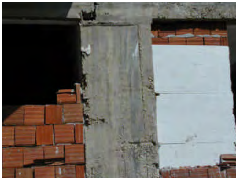
Foto 5.9: Estructura donde se aprecia la falta de vibrado del hormigón.
